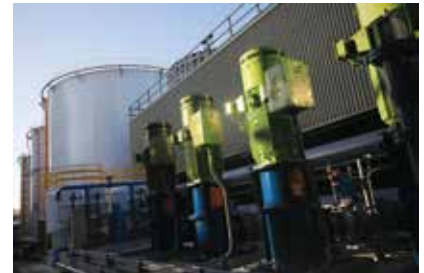
透過水力平衡分析改造冷卻水塔泵浦
