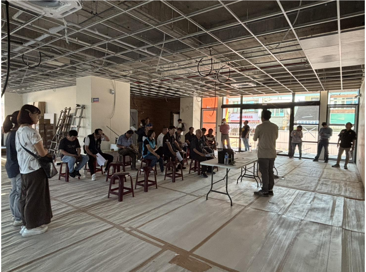
▲聽取鎮公所圖書館及建設課鎮立圖書館改建工程進度，了解現在用地問題及未來展望。
