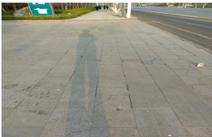
工程品質良莠不齊，路面凹凸不平
